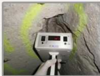
Appareil : Détecteur DG5 Mesure : 100 \text{c.s}^{-1}
