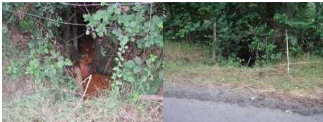
N° 18 et 19 : Drain côté site minier .
