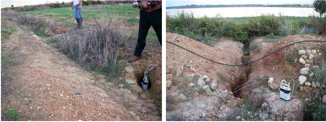
Secteur soit disant réaménagé : terre de couverture du phosphogypse lessivée par la pluie (niveau de rayonnement gamma 2 à 9 fois supérieur à la normale)
